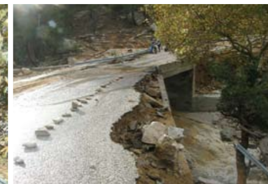
5. Σοβαρές ζημιές στη γέφυρα Γεμέλια - Βρακάδες.
