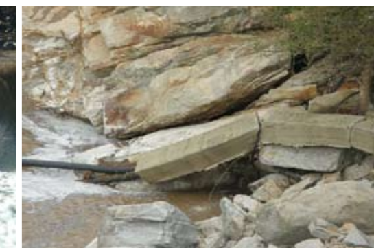
3. Καταστροφή αγωγού ύδρευσης και αποδόμηση των βραχωδών μεγαλομαζών στα οποία αυτό στηριζόταν, λόγω της δράσης του υπερχειλιστή του φράγματος Πέζι.
