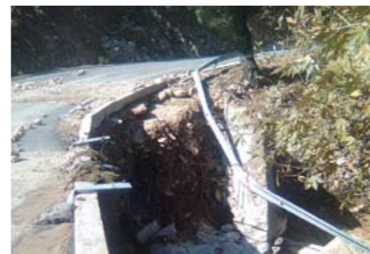
4. Καταστροφή πτερυγότιου και στηθαίων ασφαλείας στη συμβολή χ. Χάλαρη και δημοτικής οδού Γεμέλια.
